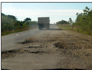
Figura 9: Estrada em péssimo estado
